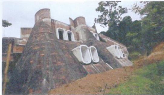
Luego de diez años se reiniciaron los trabajos de construcción de la Escuela Nacional de la Marimba.
